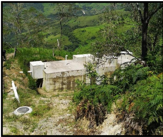
Foto 3. Planta de Tratamiento de Aguas Residuales en el barrio San Gabriel.
